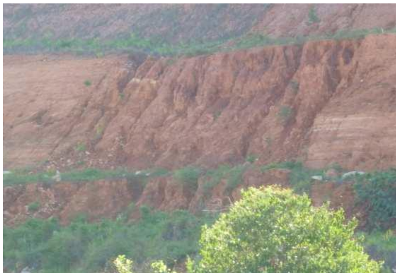
Figura 1: Talude com início de voçorocamento.
