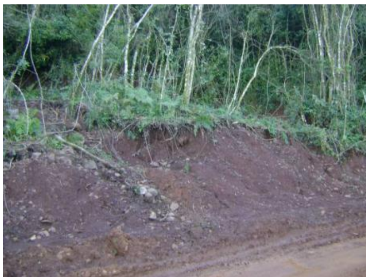
Figura 5: Talude com erosão.
