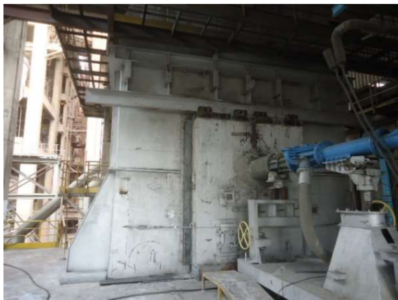
Figura 4 - Forno que realiza a queima dos resíduos (Dados do projeto, 2017)
