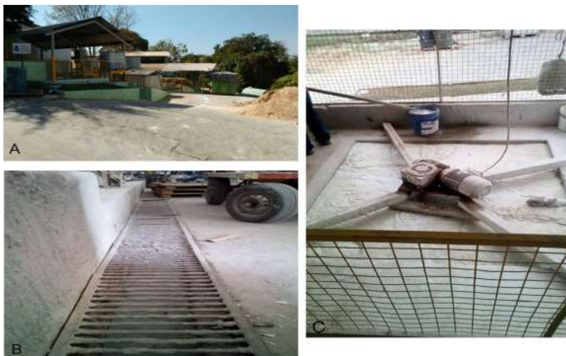
Figura 2. Geração de resíduos líquidos na indústria. A estação de tratamento de efluente; B canaletas de recepção de efluente; C tanque de mistura.
