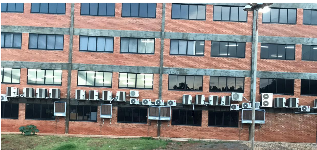
Figura 2 – Conjunto de aparelhos de climatização de ar disposto no prédio da UniEvangélica, Campus de Ceres, no município de Ceres-GO.
