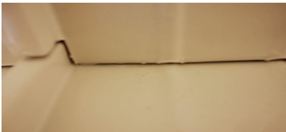
Teto em forro pvc com diferença de 5 centímetros fora de esquadro. Causa, paredes fora de esquadro. Solução (paliativa) retirar forro e fazê-lo novamente.
