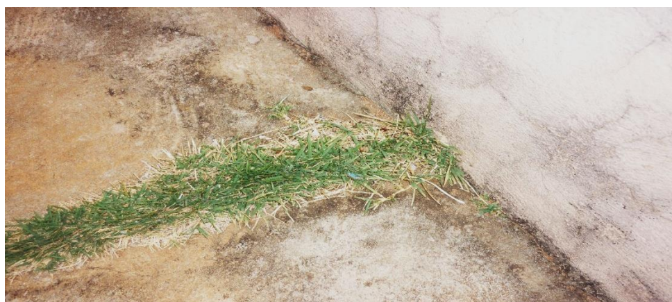
Junção de fundação com mato, patologia de fundação.
