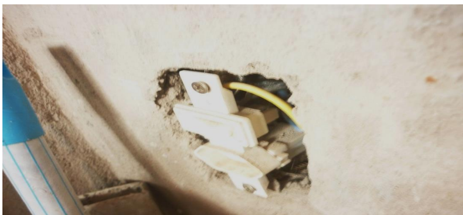
Instalações elétricas sem acabamento. Risco de choque elétrico. Solução capa de proteção e acabamento.
