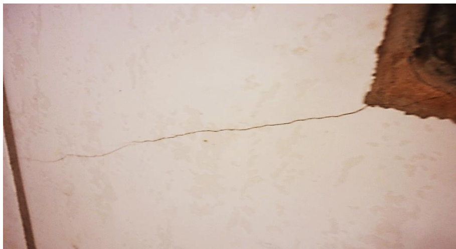
Fissuras abaixo da janela no revestimento de parede na posição horizontal causada pelo excesso de tensões provenientes vinda da fundação, ou também do não uso de vergas (aço CA 50).
