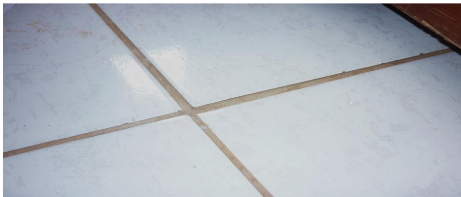
Cerâmica com diferença no alinhamento e desnível entre elas. Causa, contra piso desnivelado.
